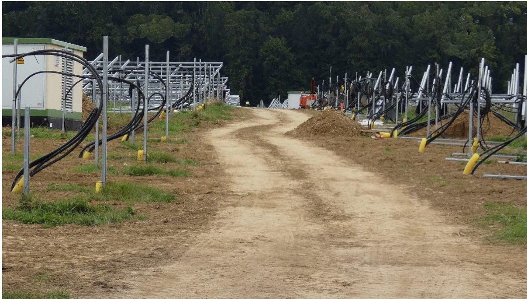
Abb. 1 Freiflächensolaranlage während der Bauphase. Die erforderlichen Kabel sind bereits verlegt und die Trägerkonstruktion im Aufbau (Fotos, soweit nicht anders vermerkt: J. Trautner).
